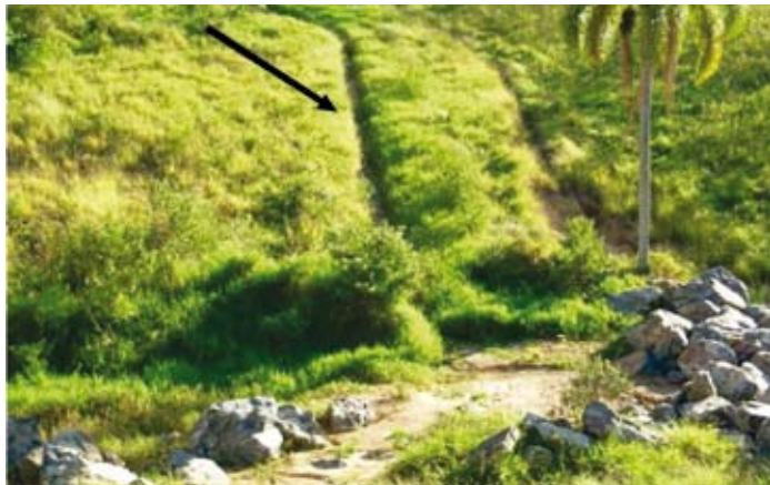
Foto 22. Parte do sistema de drenagem de uma pilha de estéril, vendo-se canaletas revestidas de concreto (indicada) e área de espera (Foto: Ana C. Neri).
