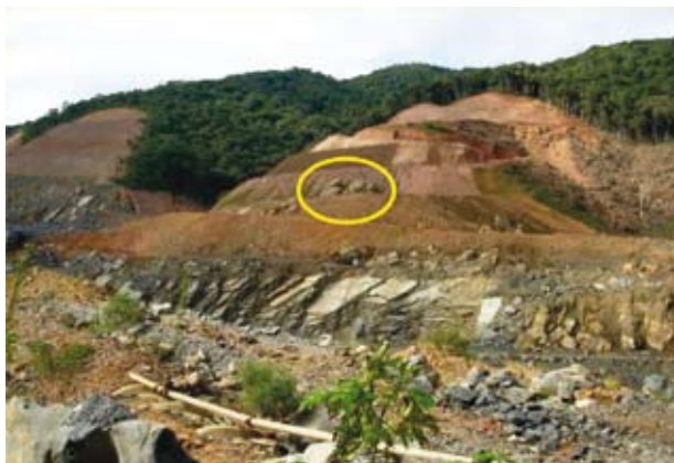
Foto 19. Taludes em recuperação nas bancadas superiores de uma mina. Notam-se, em detalhe, matacões de tamanho métrico e estáveis mantidos nos taludes para evitar o desencadeamento de escorregamentos (Foto: Ana C. Neri).
