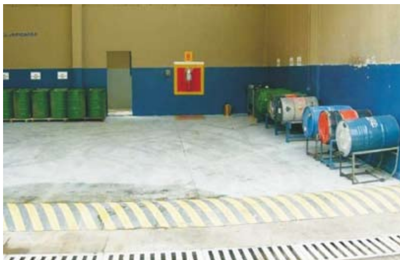
Foto 7. Área de lubrificação, dotada de piso impermeável, barreira de concreto e sistema de drenagem (Foto: Luis E. Sánchez).
