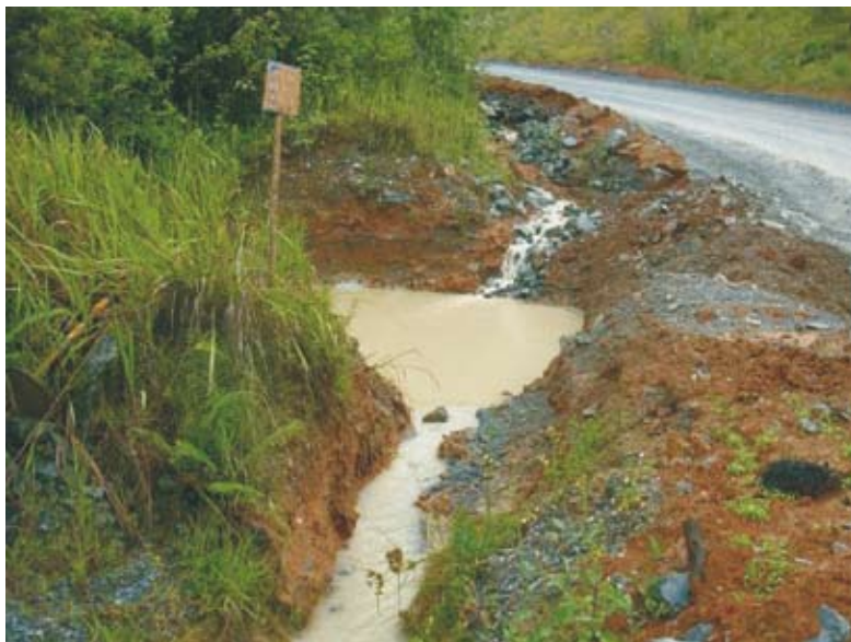
Foto 11. Sistema de drenagem composto por canaletas escavadas e bacias de decantação ao longo das vias de acesso, responsável pela retenção de sedimentos provenientes de pátios de estocagem, áreas de apoio e vias de acesso da mina (Foto: Luis E. Sánchez).
