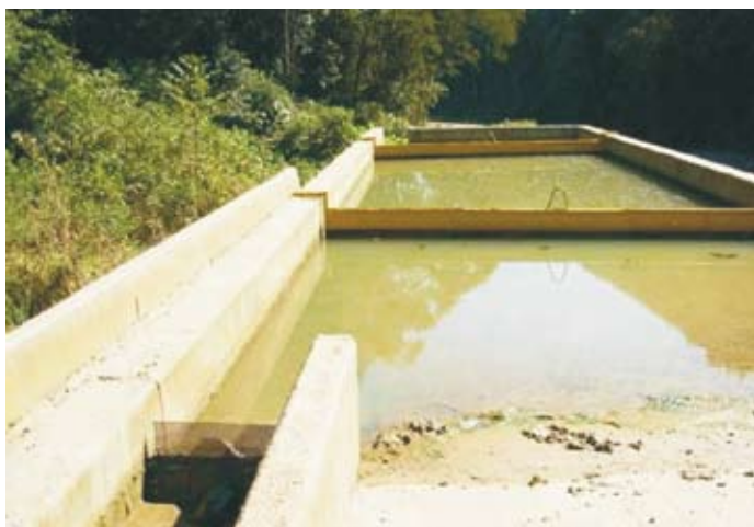
Foto 29. Bacias de decantação de concreto para retenção de sedimentos grossos. Água proveniente do bombeamento da água subterrânea de uma cava (Foto Ana C. Neri).
