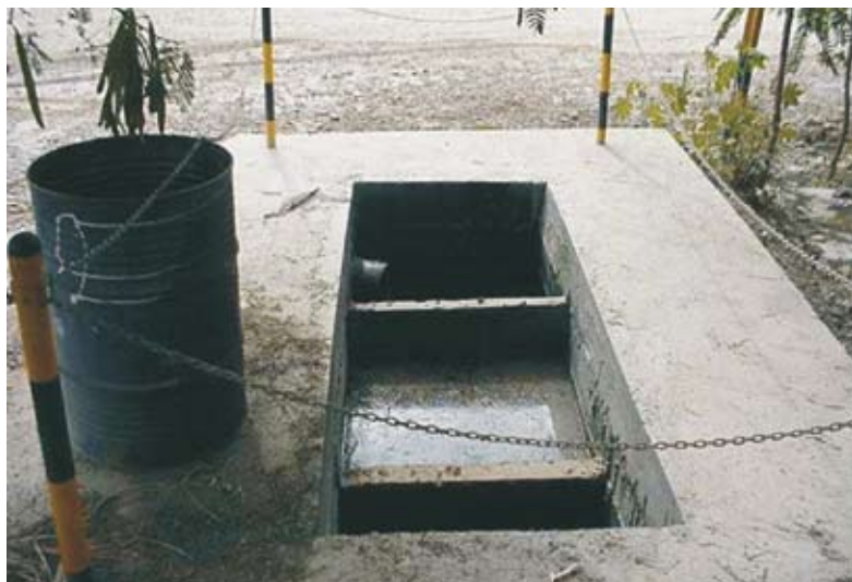
Foto 35. Separador de óleo e água proveniente da oficina mecânica (Foto: Ana C.Neri).
