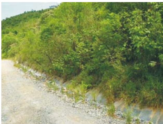
Foto 13. Vista de canaletas revestidas por rocha estéril (dolomito) derivada de uma mina (Foto: Ana C. Neri).
