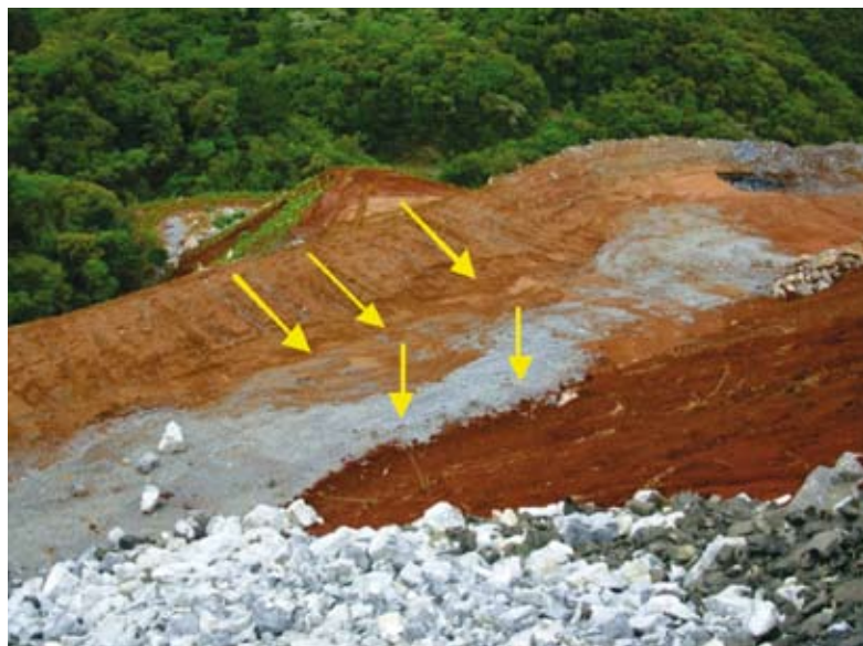
Foto 21. Sistema de drenagem de uma pilha de estéril composto por bermas inclinadas (0,5%) que disciplinam o escoamento superficial (flechas) para o pé do talude superior de infiltração (Foto: Luis E. Sanchez).
